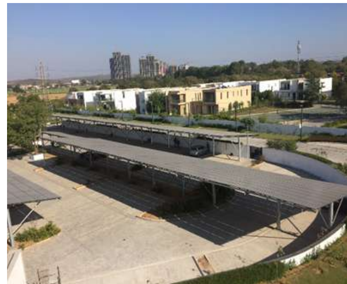
Karma Lakelands (HR.) - 405 KWp
