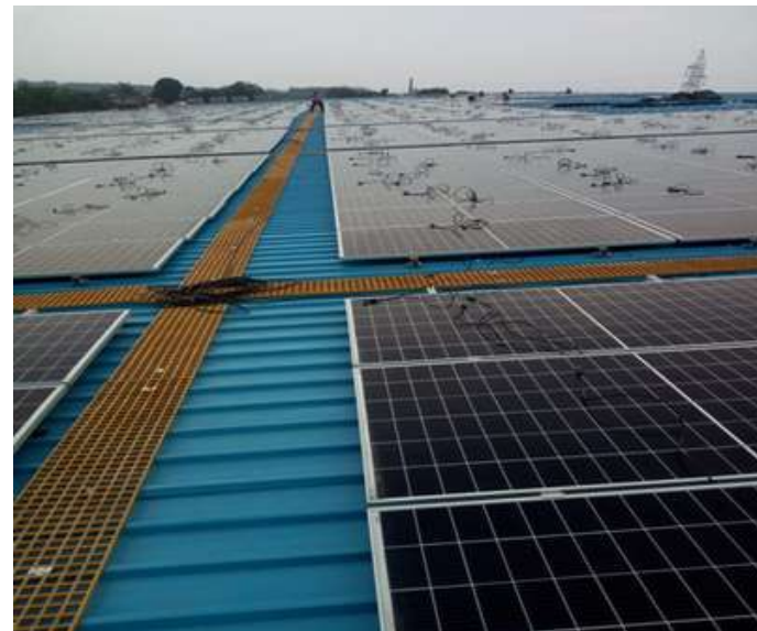
Filatex India Ltd. (DNH) - 915 KWp
